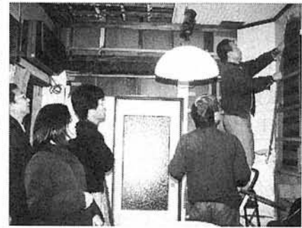
材の腐朽状況の確認
