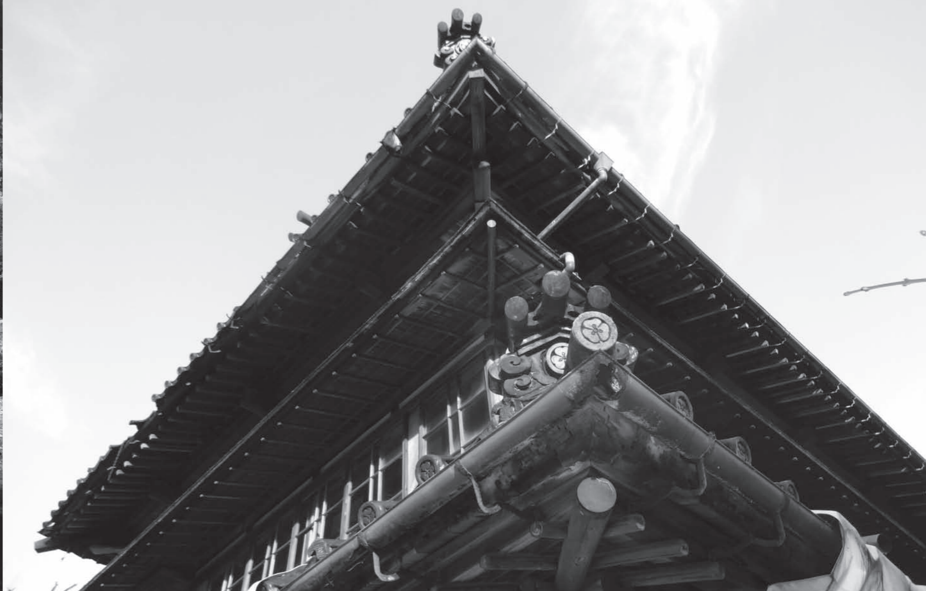
建物内部も素晴らしいですが、外側もとても精緻な木組み。残念ながらいたる所に欠損が見られます。
