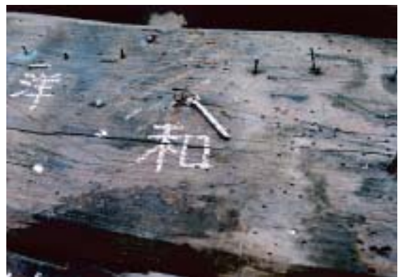
洋釘に混じって和釘の跡が見られる
