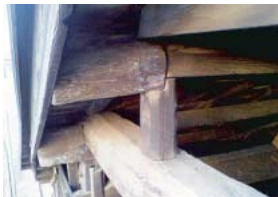
母屋桁の切断痕跡
