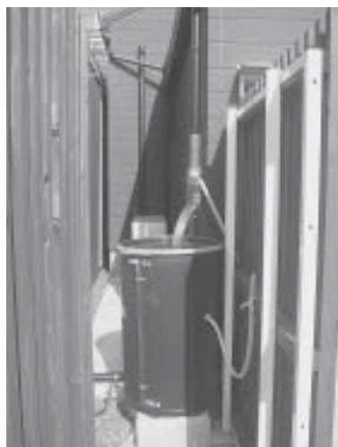
ひろばに設置された雨水タンク
